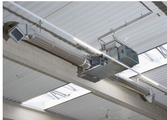
Abbildung 16: Warmlüfterzeuger mit Außenluftanschluss über Dach und Raumlufteinlass für Um-, Misch- und Außenluftbetrieb
