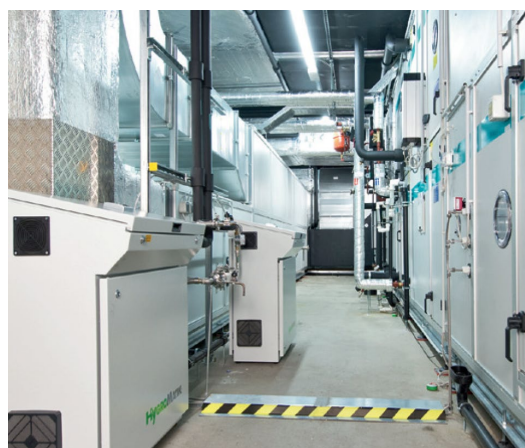
Abb. 48: Technikum der Blutzentrale mit RLT-Zentralgeräten und zwei Hochdruck-Befeuchtungsanlagen
