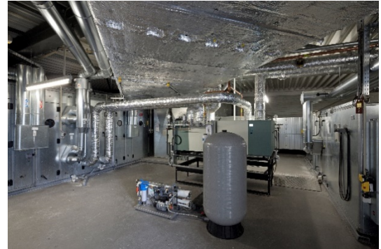
Abb. 44: Wasseraufbereitung und Dampferzeugung
