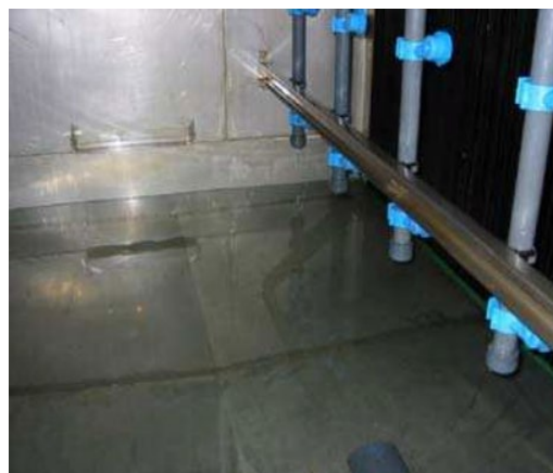
Abb. 20: Wanne eines Luftwäschers
