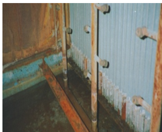
Abb. 23: Hygienisch bedenklicher Umlaufsprühbefeuchter
