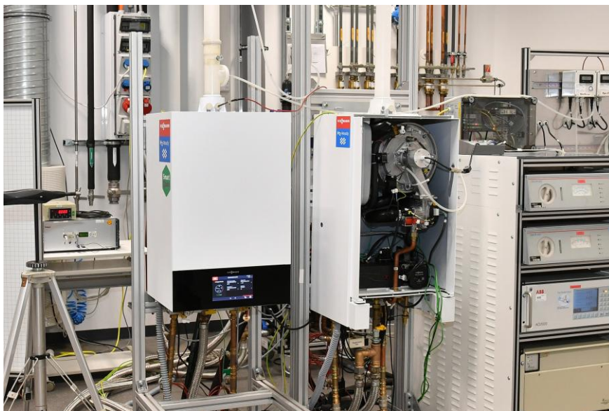
Abbildung 1: 100%-H 2 -ready-Heizung am Prüfstand.
